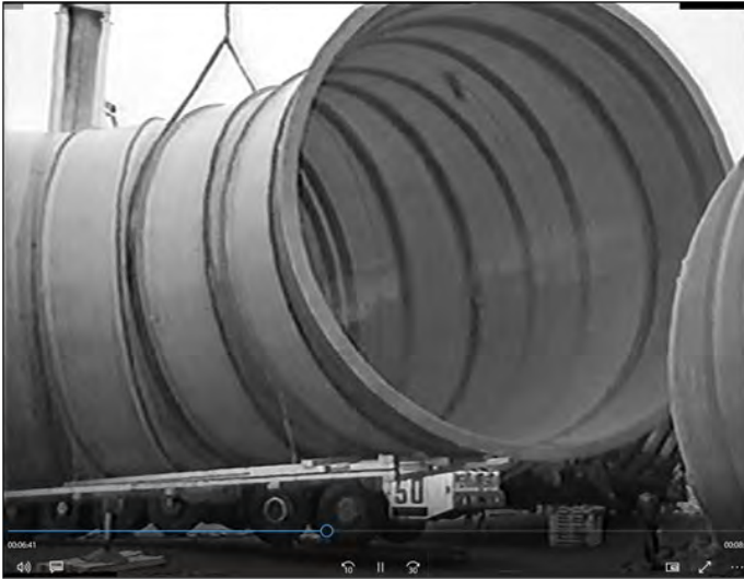
L'une des tuyauteries en matériau composite d'amenée des gaz à la tour correspondante.
